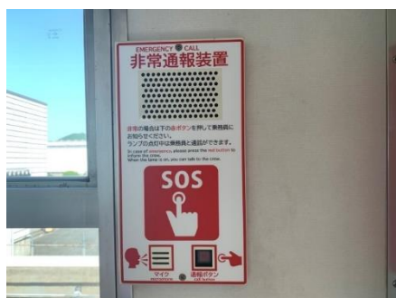
各客室に設置しています
