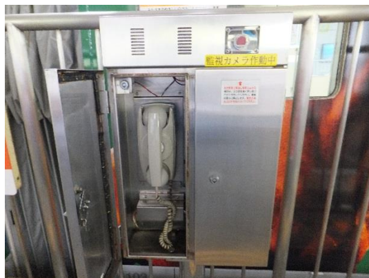
左側は駅務室との直通連絡電話
