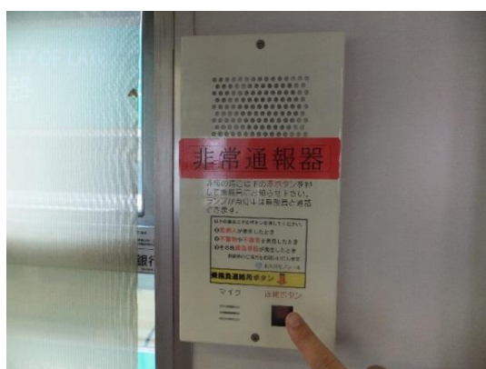
各客室に設置しています
