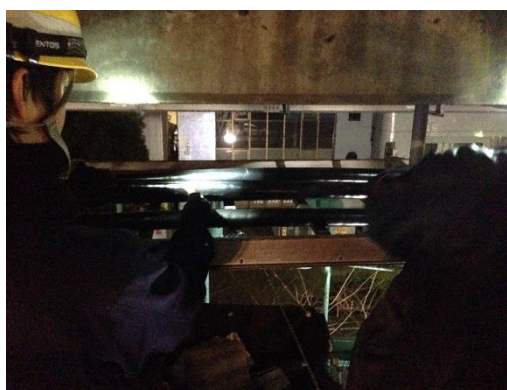
通信ケーブルの点検
