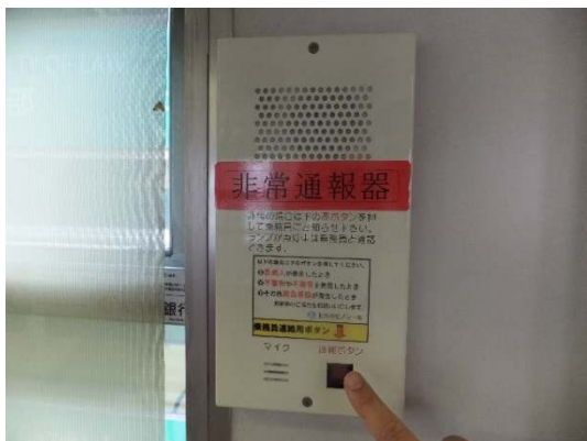
各客室に設置しています
