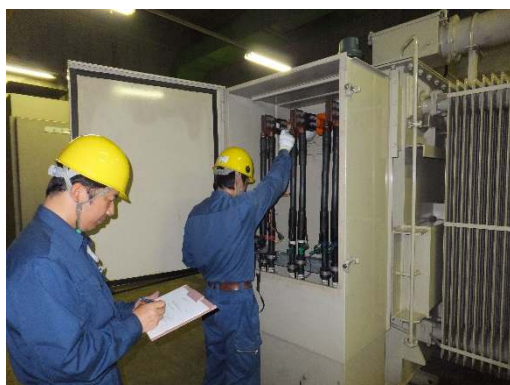
変電所設備の点検
