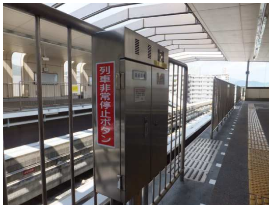
全駅の上下ホームに２か所ずつ設置しています
