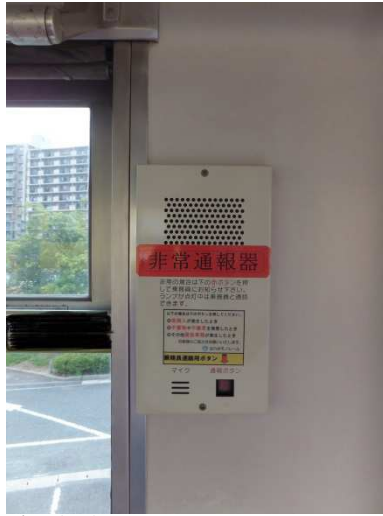
各客室に設置しています
